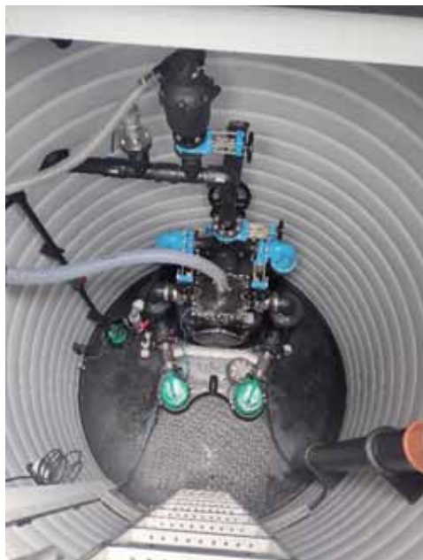
Technologie čerpací stanice.
